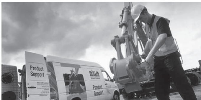
Slika 166. Dodatna usluga instaliranja opreme
