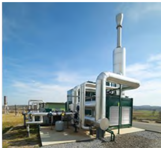
Slika 47.: Bioplinsko postrojenje - kogeneracijska jedinica
